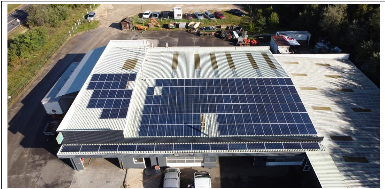
48,640 kW teljesítményű napelemes rendszer
